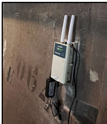
Figura 3: centralita tipo instalada
