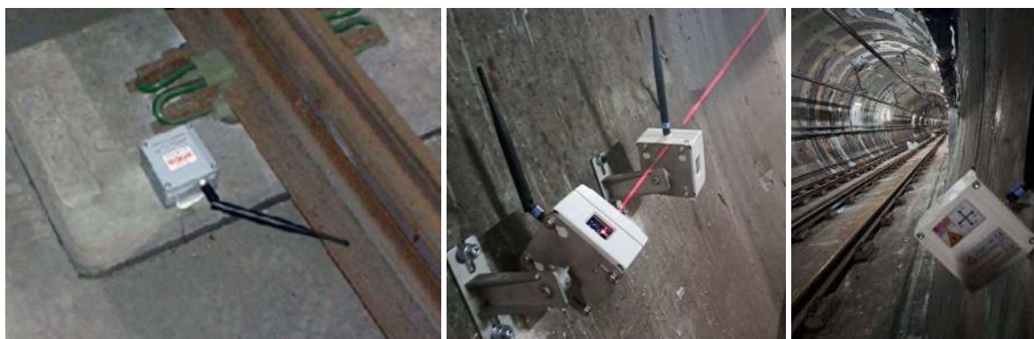
Figura 24: Ejemplos de instalación de tilt en plataforma (medida de asientos) y en sección túnel, con distanciómetro laser (medida de convergencias)
